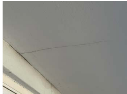
Sprekke og nedbøyning av plate i balkongtak
