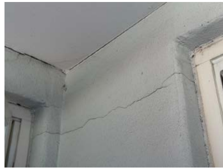
Riss og sprekker i veggoverflater.
