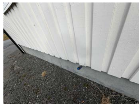
Eksempel på råte.
