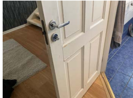
Døren i badet i 1. etasje har synlige merker/skader etter damp.
