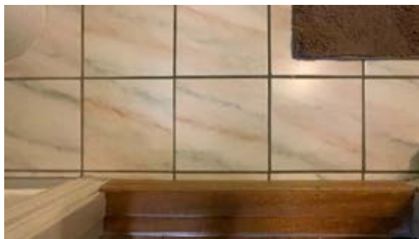
Løse fliser ved dør.
