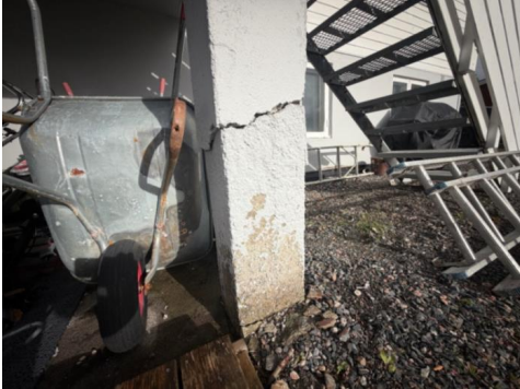
Sprekk/setning i betongsøyle som er bærende for begge verandaene.
