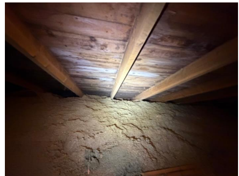
Det er åpning mellom isolasjon og undertak, men ikke etablert luftespalter utvendig.
