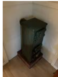
Uten plate på gulv foran ildsted
