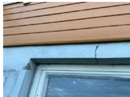
Oppsprekking over vindu
