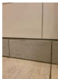
Ikke fuga mellom plate og bunnprofil.
