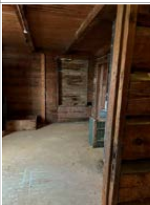
Enkel/uisolert bygning, lysskimt fra gjenkledde vindu, boremel på gulv. Fuktskada konstruksjoner (lekkasje tak).
