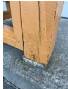
Fukt/råteskade nedre del søyle
