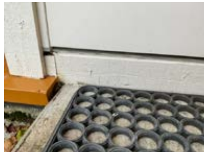
Ikke beslag under dør mot nord
