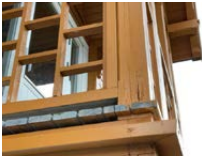
Fukt/råteskade nedre del søyle
