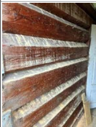
Store mengder boremel på tømmer og gulv
