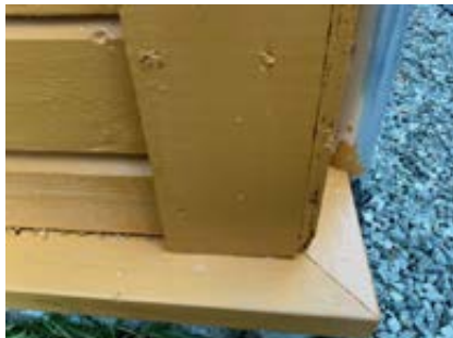
Råte i hjørnebord tilbygg øst
