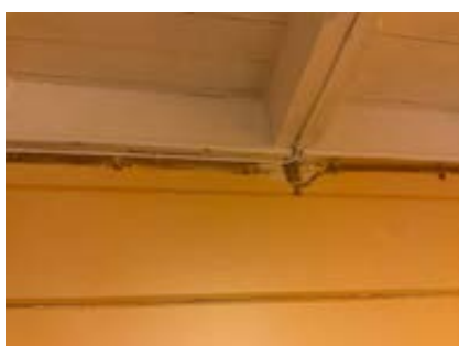
Overflateavvik etter endra el.opplegg
