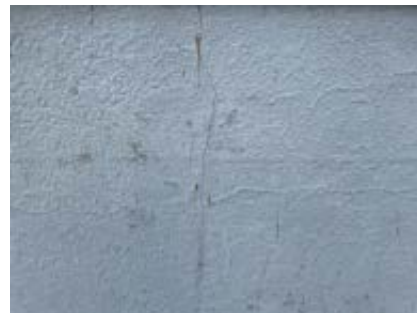
Riss/mindre sprekk sørside
