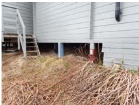
Råteskadet retrappp opp til altan
