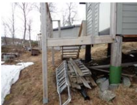
Skjevheter i treplating foran hovedinngang. Sig i fundamenteringen
