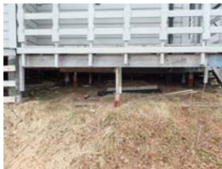
Skjev søyle for altan
