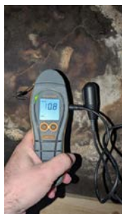
Gammel fuktskade (ikke målt fuktighet)
