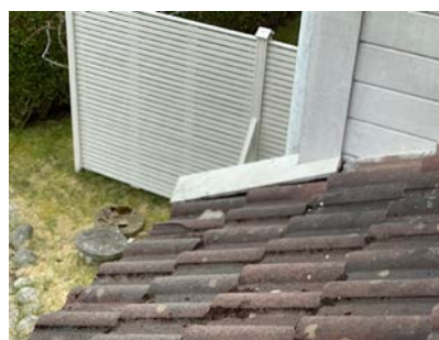
Skadet takstein på overbygg til inngang.
