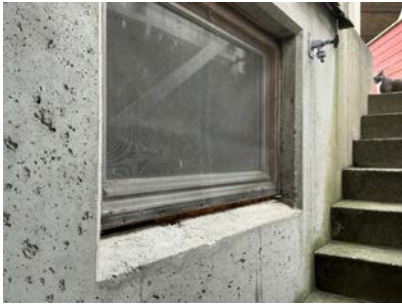
Fuge mellom vindu og grunnmur mangler og tetting er usikker.
