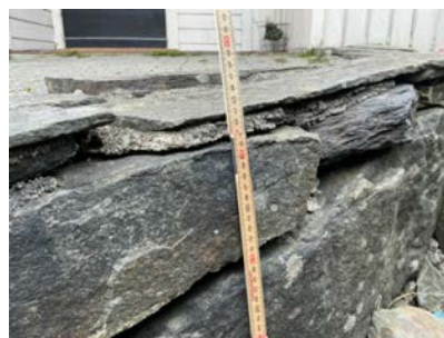
Utvendig støttemur ved inngang er lavere enn 50 cm.
