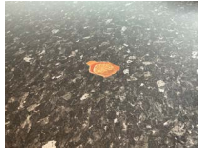
Skade på benkeplate.
