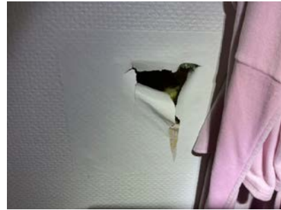
Hull i vegg på soverom.
