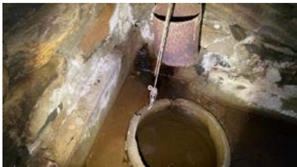
Synlig vann i krypkjeller
