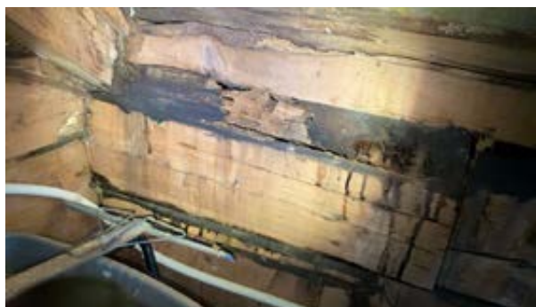
Tørr-råte i tømmer på loft
