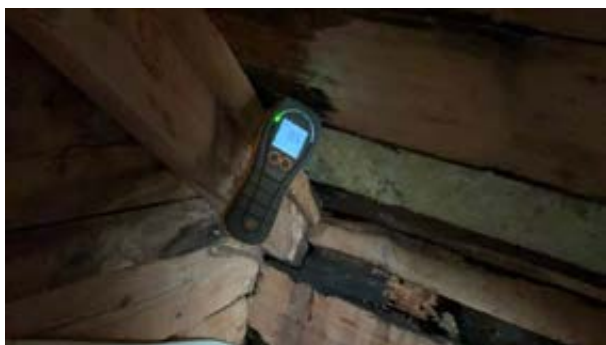
Råteskader i takkonstruksjon - tørr råte
