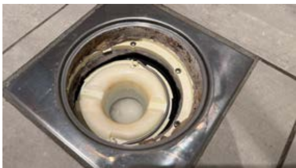
Synlig membran under slukens klemring.
