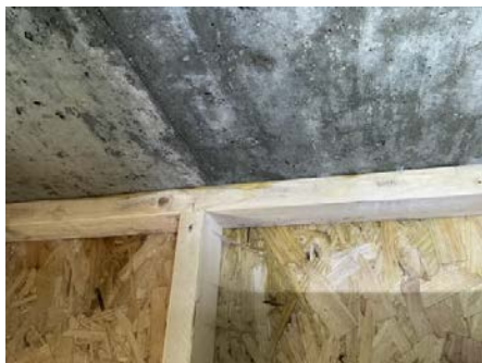
Synlig fukt i tak under balkong.
