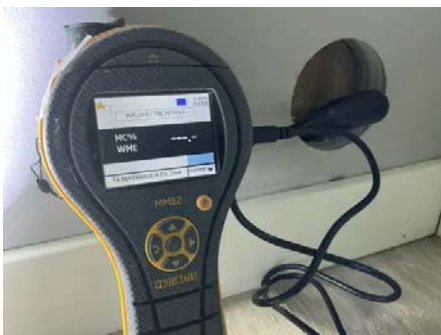
Det er flere lag med veggplater og planke-vegg bak. Hulltaking på vegg/plate og sems er derfor ikke mulig. Ved fukt-søk i planke-vegg er det ikke registrert unormale verdier.
