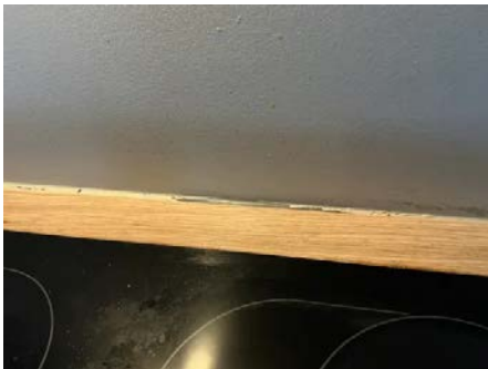
Maling på silicon-fuge ved koketopp er flasket av. Vurderes som normal slitasje.
