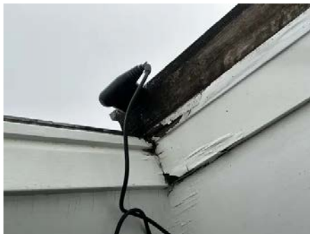
Spredt fukt/råteskade på takvindu på loft.
