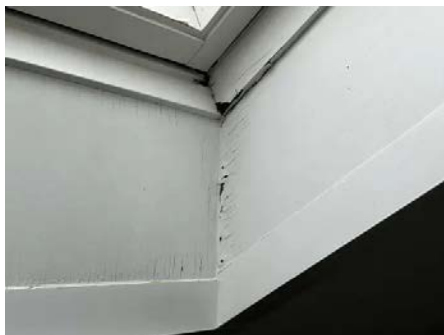
Fukt-merker/råteskade på karm/foring.
