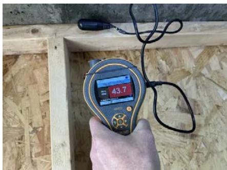
Ved fukt-søk i sems mot tak er det registrert forhøyede verdier.
