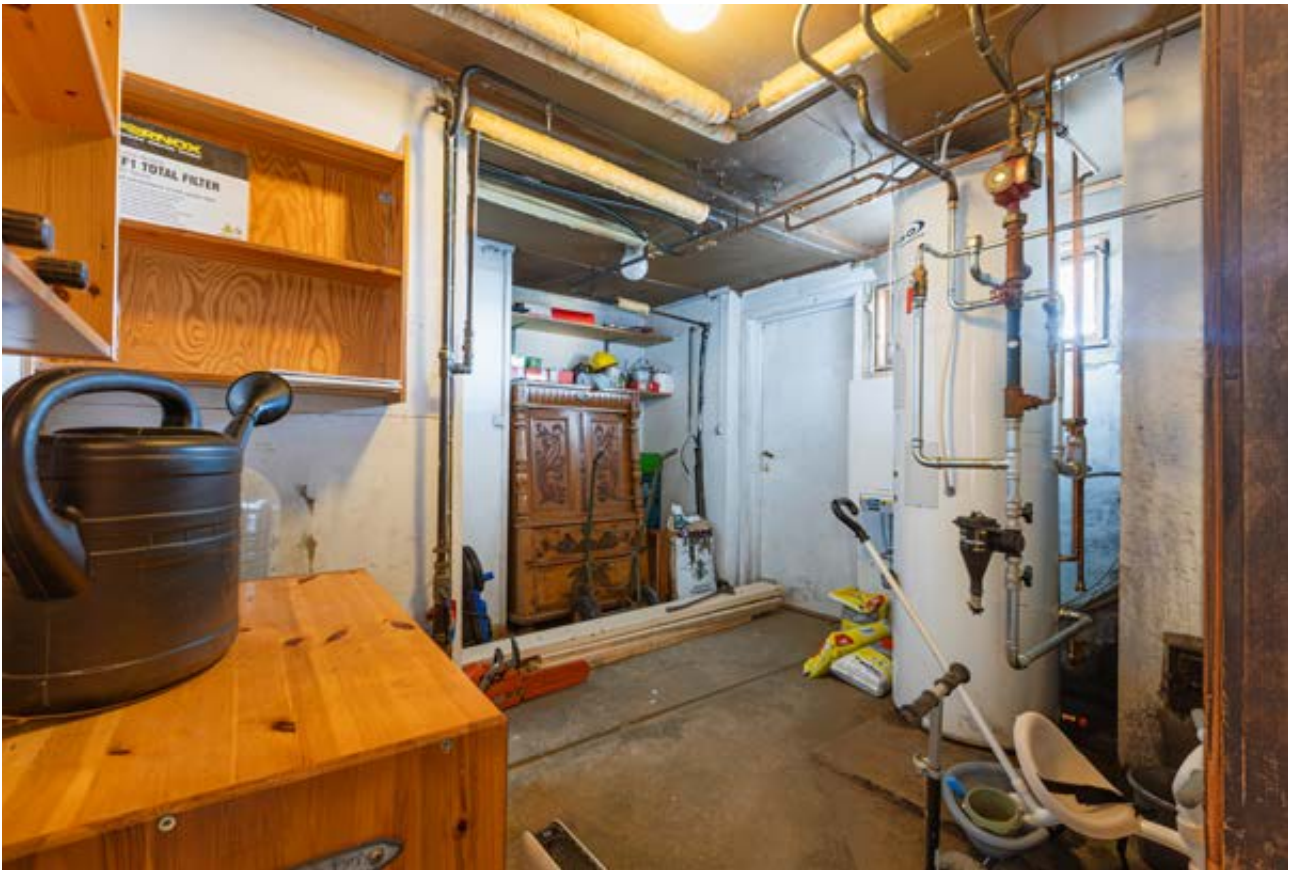
Teknisk rom med varmtvannstank og rørinstallasjoner. Egen utgang til carport.
