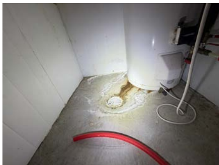
Varmtvannsbereder i krypkjeller i tilbygg.
