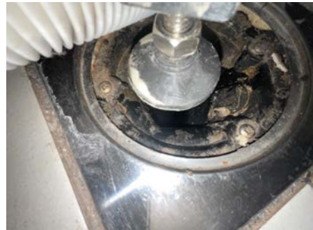
Sluk under dusjkabinett.
