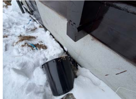
Sprekk i grunnmur og puss.
