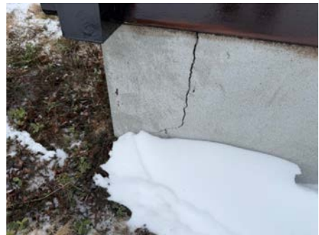
Sprekk i grunnmur og puss.
