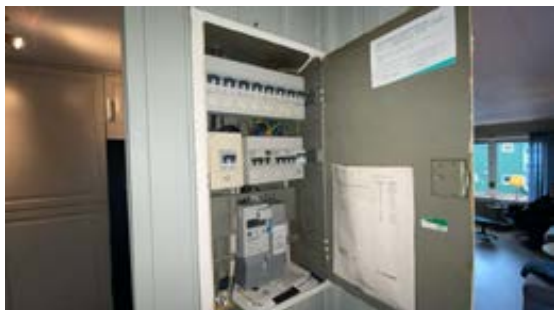
Sikringsskap i gang med trapp i 1. Etasje.
