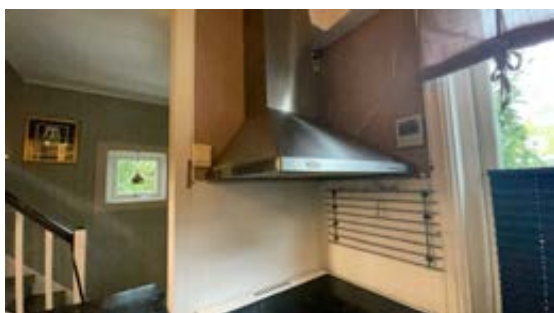
Ventilator på vegg.
