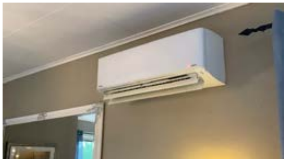
Varmepumpe på vegg i stue 1. Etasje.
