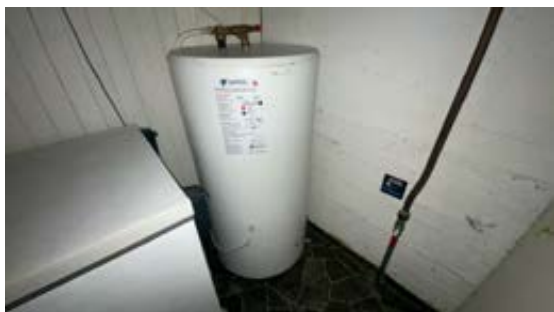
Varmvannsbereider i vaskrom.
