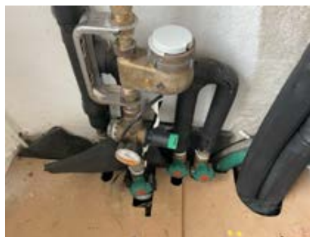
Stoppekraner og vannmåler.
