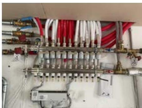
Teknisk rom med fordelere for vannbåren varme.
