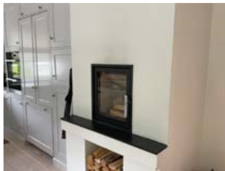
Integrert peisovn på kjøkken i 1.etasje.
