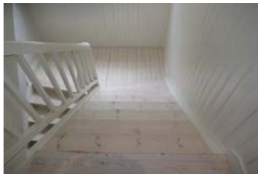
Tretrapp uten håndlist på vegg i trappeløp.
