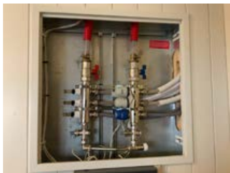
Fordelerskap for vannbåren varme.
