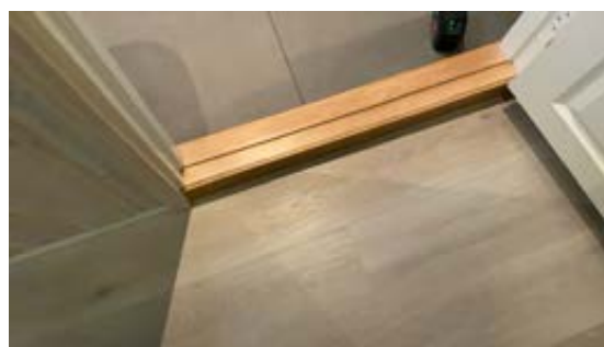
Oppkant ved dør på ca. 20 mm.
