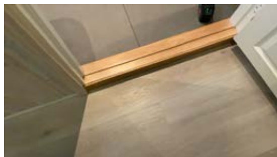
Det er en del knirk ved dør til bad i h.etg.
