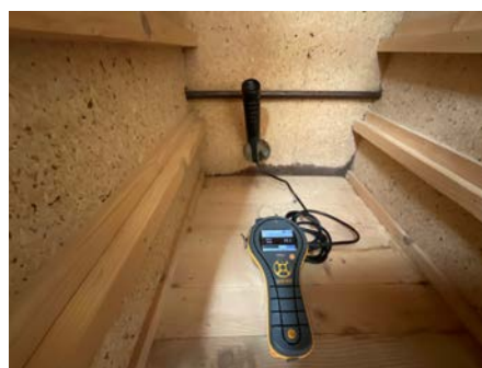
Ikke utslag på fukt i vegg mellom grovkjøkken og bad.
