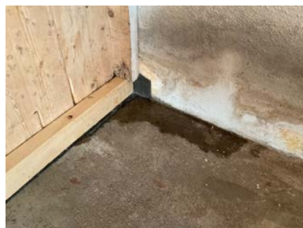
Synlig innsig av vann i kjellerbod mot sørøst.
