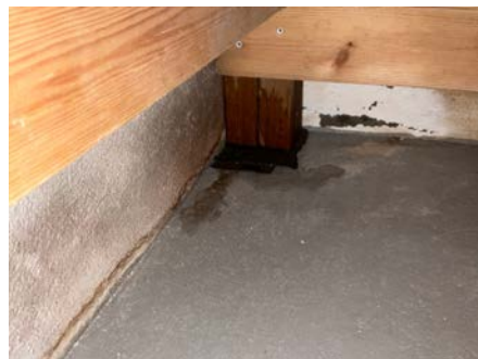
Synlig innsig av vann under kjellertrapp.
