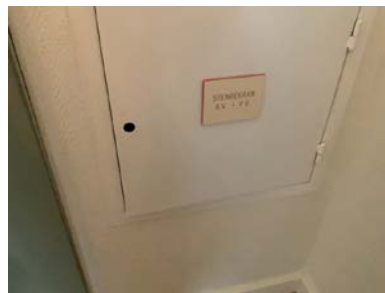
Løse for hovedkrane ved kjøkken.
