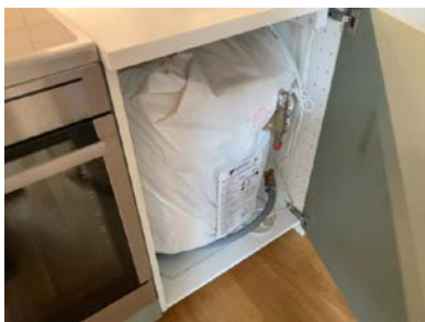
Varmtvannsbereider plassert i underskap å kjøkken.
