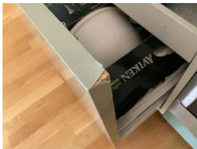
Mindre skader/bruksmerker på innredning/benkeplate.
