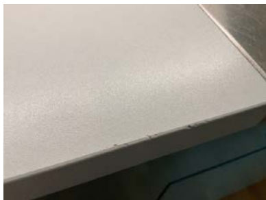
Mindre skader/bruksmerker på innredning/benkeplate.
