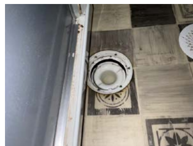
Sluk under dusjkabinett
