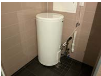
Varmtvannstank plassert på bad
