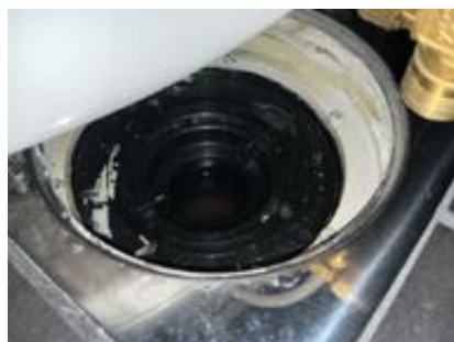
Slukmansjett synlig i sluk ved varmtvannsbereder
