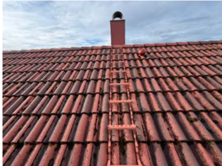
En del mose på takflaten mot nord.
