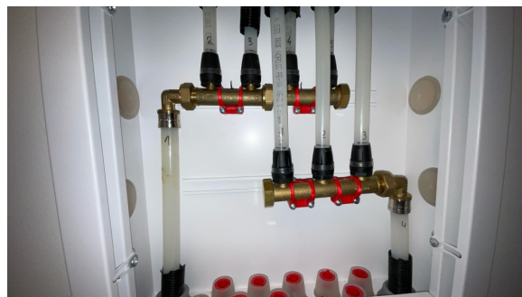
Fordelerskap vaskerom/teknisk rom.
