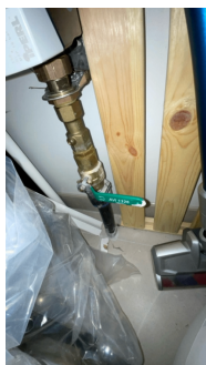
Hovedstoppekran i vaskerom/teknisk rom.
