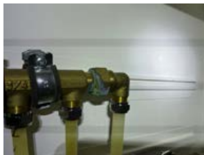
Noe korrosjon på kobling. Bør undersøkes nærmere og utbedring foretas.
