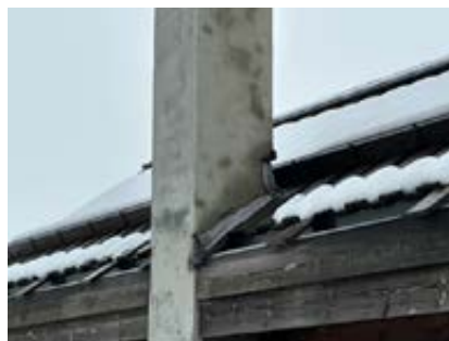
Noen sprekker i puss på pipe over tak.
