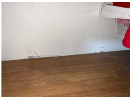
Avflasset maling ned mot gulv.
