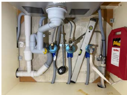
Røropplegg i kjøkkenbenk
