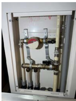
Rørskap på kjøkken med 2 x stoppekraner.
