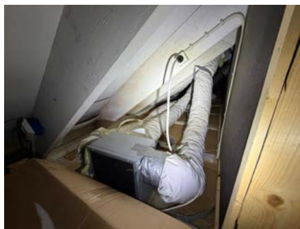
Bilde tatt i fra raftekott.
