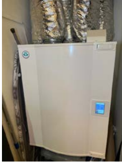
Aggregat plassert bak skyvedørgarderobe.
