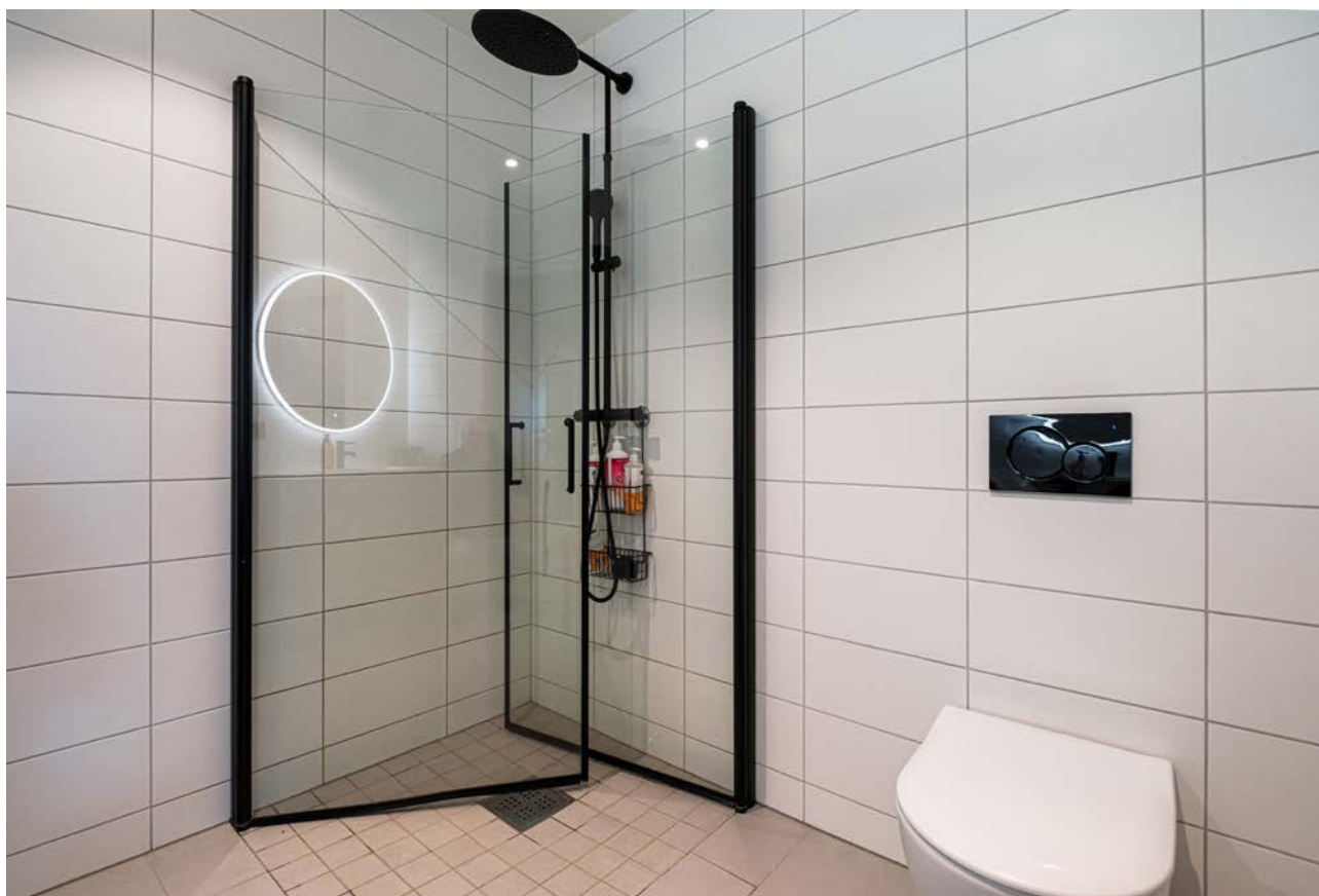
Badet i underetasje er utstyrt med en innredning som inkluderer en nedfelt servant og dusjvegger med hjørneløsning
