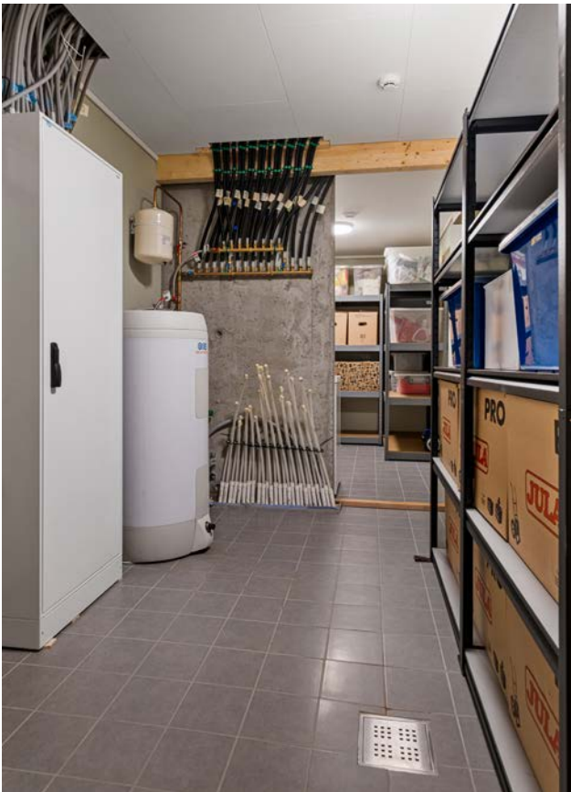
Teknisk rom med varmtvannstank og oversiktlig rør-i-rør-system
