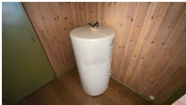
Varmtvannstank er plassert i gang og ikke koblet til på soverommet der den egentlig skal stå.
