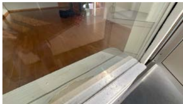
Litt værslitte karmen på trevinduer.
