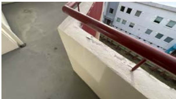
Oppsprukket maling og puss
