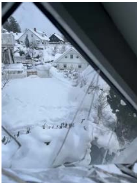
Sprekt glass i 2.etasje
