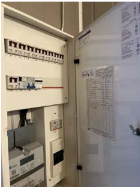
EL-skap med automatsikringer
