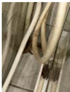
Rørgjennomføring i gulv i våt sone.
