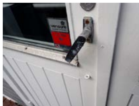
Korrosjonsskade dørvrider balkongdør
