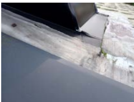
Sprekk i blybeslag pipe
