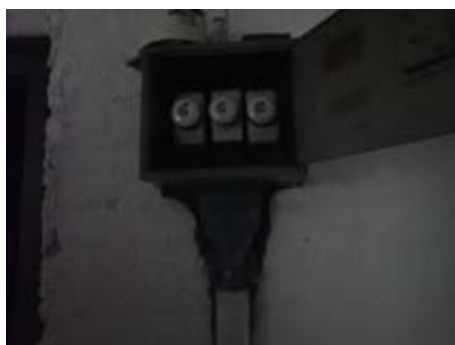
Inntakssikringer fra byggeår
