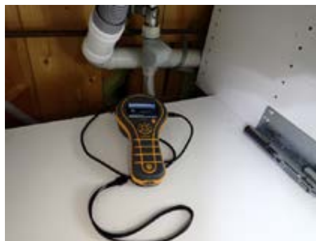
Målt tørt i vegg mot bad.
