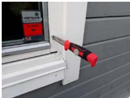
Råteskade i vindu
