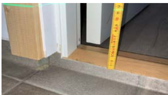
Ikke fagmessig utførelse av oppbrett på gulvbelegg.
