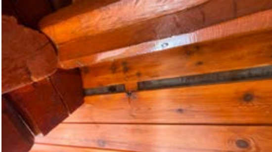
Skadet insektsnetting i raftekasse.
