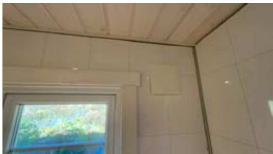
spjeldventil på yttervegg.
