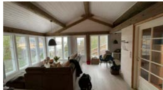
Bildet viser overflater i tilbygg fra 2013 og manglende utforing og karmlist.
