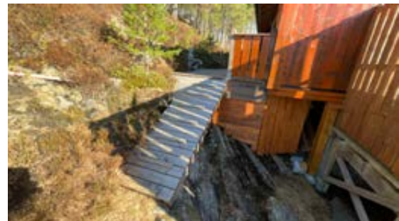
Rampe for tilkomst terrasse ved hovedytterdør. Det mangler rekkverk.
