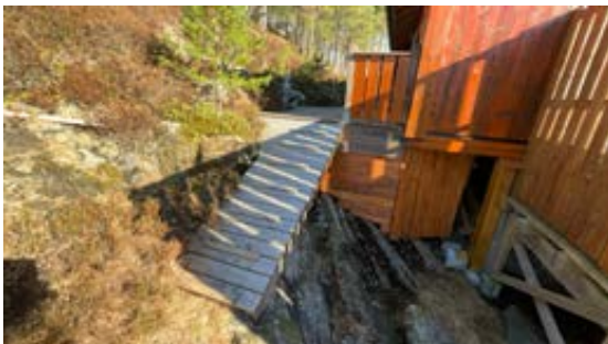
Trapp/ rampe for tilkomst terrasse ved hovedytterdør mangler rekkverk.
