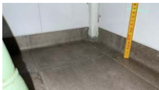
Ikke fagmessig utførelse av oppbrett på gulvbelegg.
