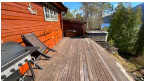
Det er ikke montert rekkverk ved spabad
