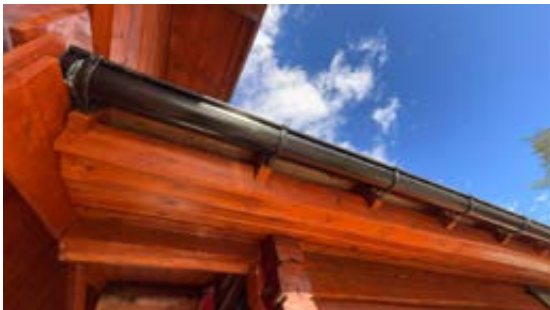
Lufting med stor åpning bak takrenne og fare for inntrenging av insekter, mus, fugler og snø.
