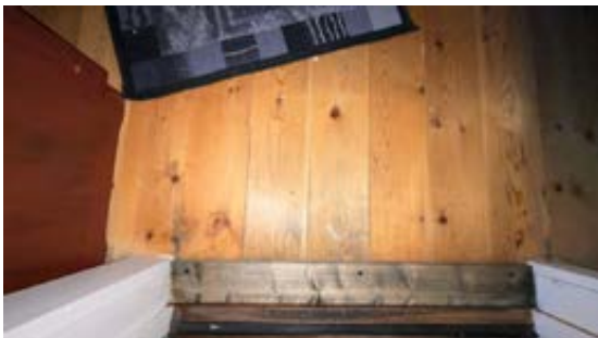
Misfarget gulv ved døråpning
