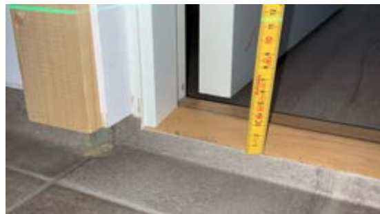
Høyde oppbrett gulvbelegg. 23mm over sluk.
