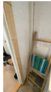
Ikke fagmessig utførelse av baderomsplate.
