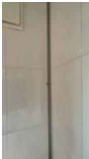
Ikke fagmessig utførelse av baderomsplate.
