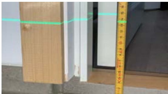
Høyde gulv ved dørterskel. 2 mm over sluk.
