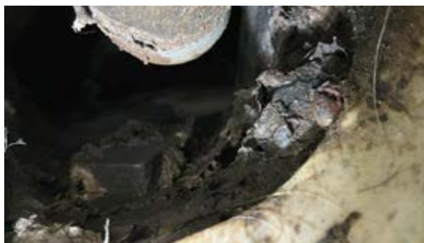
Sluk under dusjkabinett
