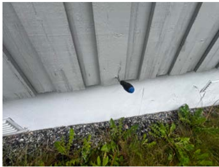
Råte på vestvegg.
