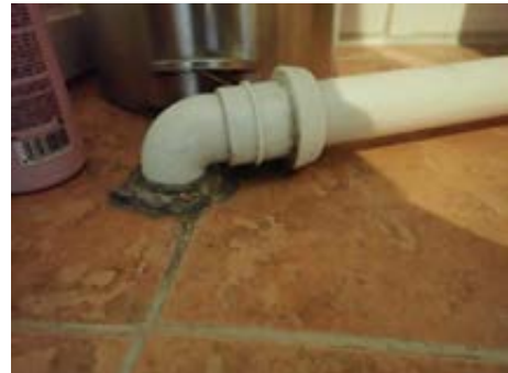
Ingen mansjett rundt avløpsrør i gulv.
