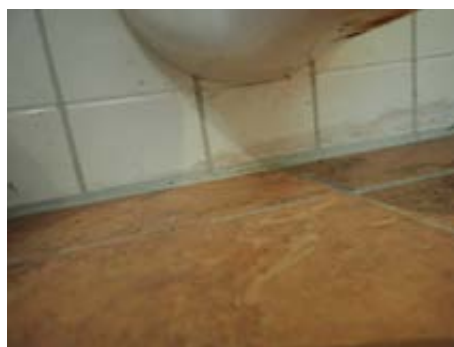
Ingen drenering under veggheng wc
