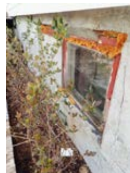
Sprekk i mur ved vindu mot terrasse
