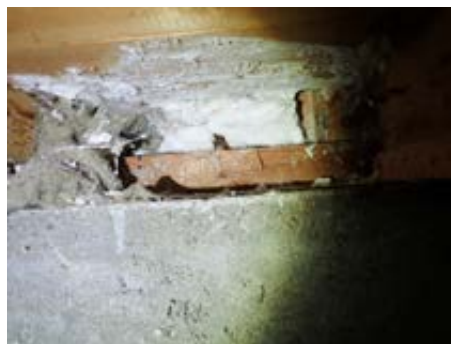
Sopp over grunnmursvi
