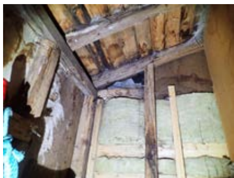
Råteskader i takkonstruksjon og i bindingsver
