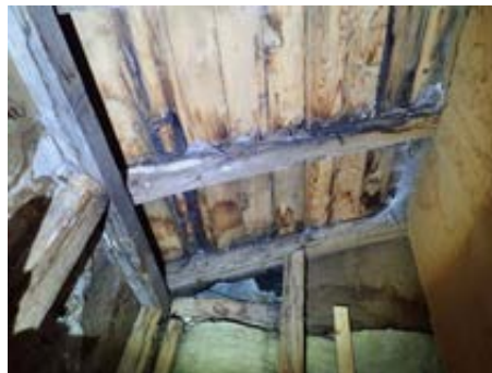
Råteskadet og mugg på sperrer og trobord.
