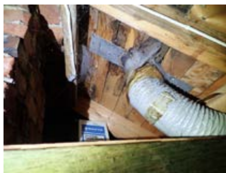
Fuktmerker i taktro.
