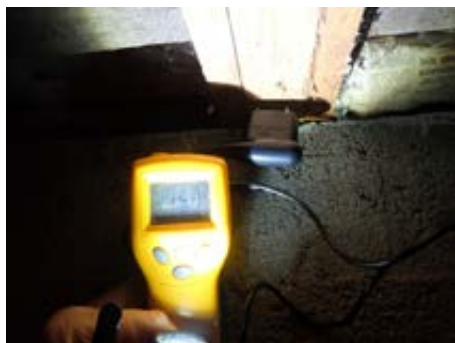
16% fukt i trebjelkelaget
