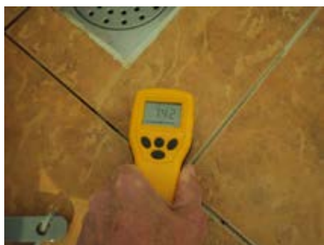
Mye fuktindikering i dusjhjørne. Her er deler av fugen borte
