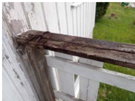
Råteskadet håndlist 1. etg.
