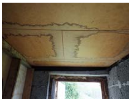
Fuktmerker i takplatene - sannsynlig pga. lekkasje fra overforliggende kjøkken og rom med opplegg for vaskemaskin.
