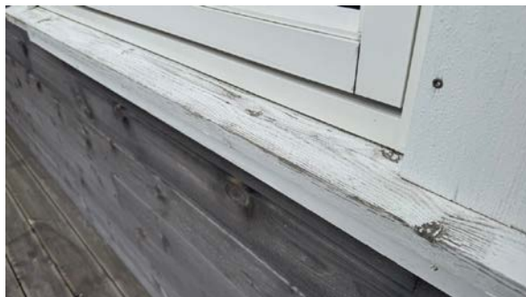
Vinduer i normal stand, belistning med vedlikeholdsbehov
