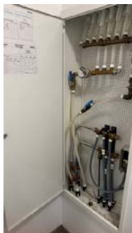
Løse vannledninger i sentralskap
