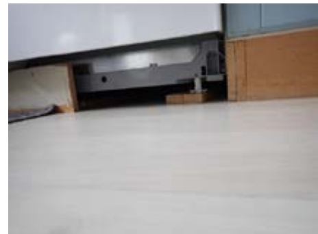
Sokkel mangler under oppvaskmaskin
