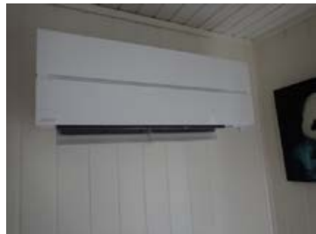
Varmepumpe luft til luft
