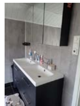
2 x servanter over innredning
