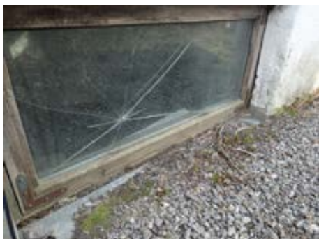
Kjellervindu med knust glass
