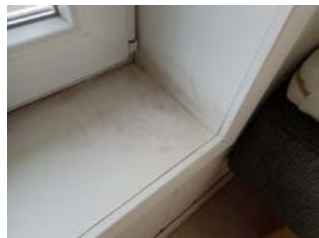
Fuktskader i foring
