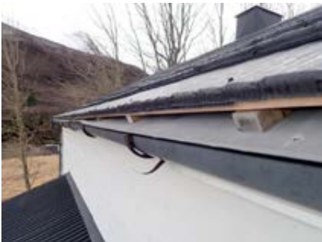
Mangler spillblikk Rustet takrennekroker.
