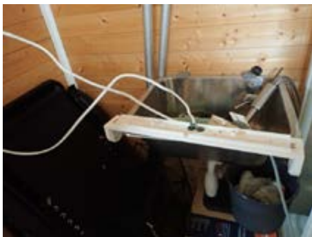
Løs taklys armatur med ledninger på vaskerom.
