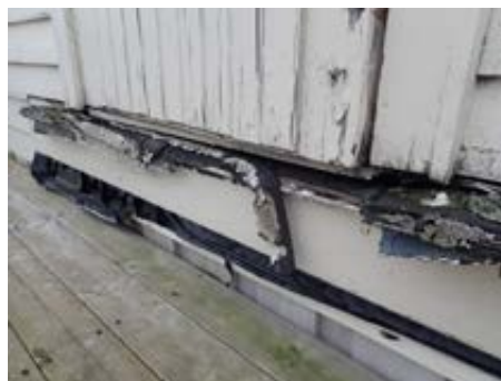
Vegg under altandøra må fornyes. Fare for råteskader er påregnelig
