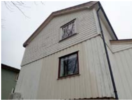
Værslitt kledning. Bør overflatebehandles.
