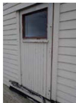
Trekkfull og råteskadet altandør må byttes.
