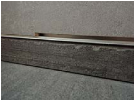
Store avvik - åpning mellom aluminiumsflit og veggplate.
