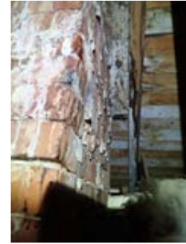
Fuktmerker i taktrao og sperre ved pipegjennomføring.
