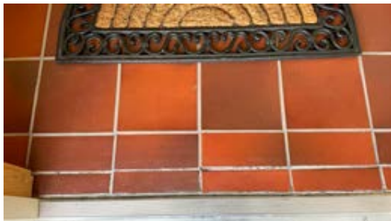
Bom og sprekker i flisfuger ved hoveddør
