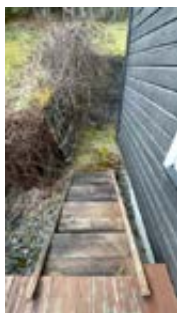
Oversikt. Bør monteres håndløper på minimum en side
