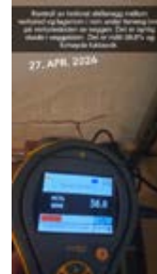
Kontroll av innført skillevegg mellom verksted og lagerrom inne mot verkstedet. Det er synlig skade i veggplaten. Fuktmåling viser 38,8% og forhøyde fuktavvik
