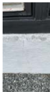
Sprekker i puss/overflate foran vindu i front
