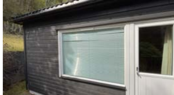
Stuevindu ved balkongdør
