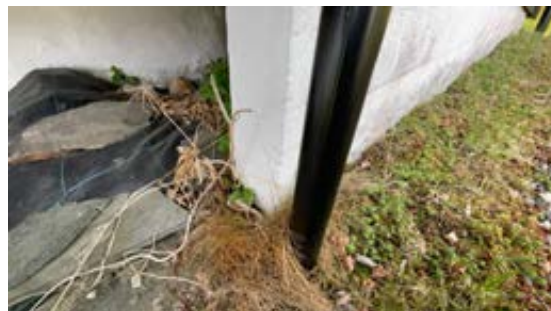
Sprekker i ringmur på tilbygg
