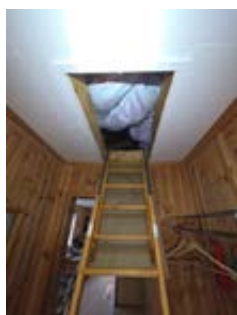
Loftsluke er ikke tett og isolert. Selger har lagt en vintermatte som sikring over loftsluke.
