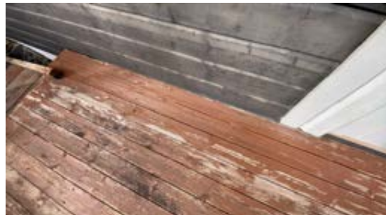
Det er ikke montert beslag mellom yttervegg og balkong/terrasse
