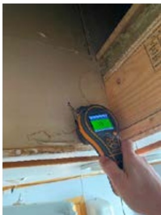
Fuktmerker i luke på storkjøkken
