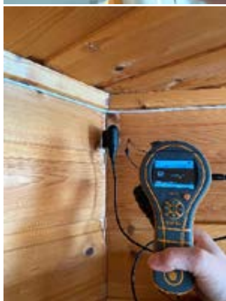
Fuktmerker i himling i inngangsparti - ikke registrert fukt.
