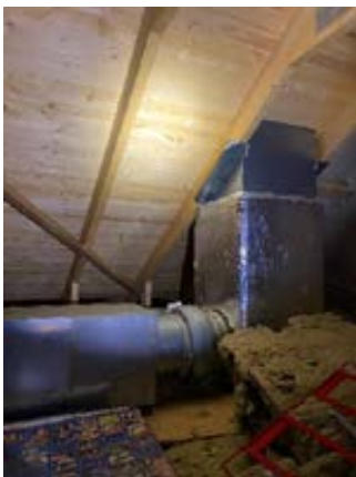
Ventilasjon fra storkjøkken
