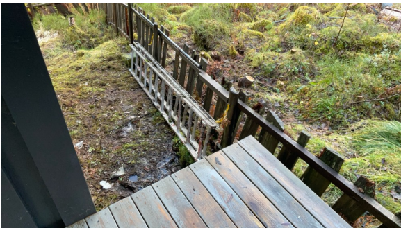
Platting nord, værslitt overflate, fallhøyde
