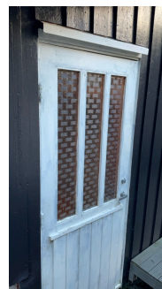
Værslitasje bi-inngangsdør mot bod/aggathus
