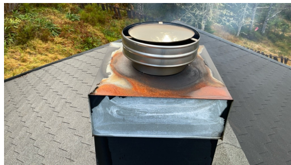
Pipekledning/pipehatt, avflassing og korrosjon
