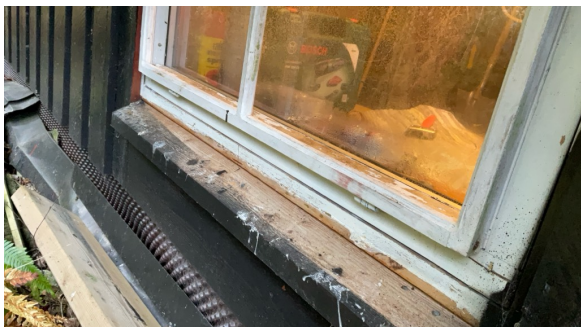
Vindu uten beslag på vannbrett
