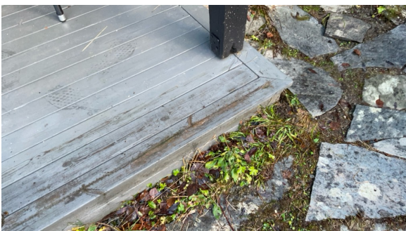
Værslitasje, konstruksjoner montert mot/nærme grunnen
