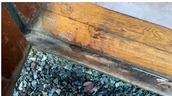
Tegn til at fukt trekker inn mot dør
