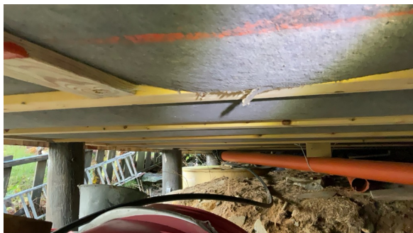
Vindsperre med åpning
