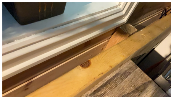
Gjenstående arbeid Gjenstående arbeid
