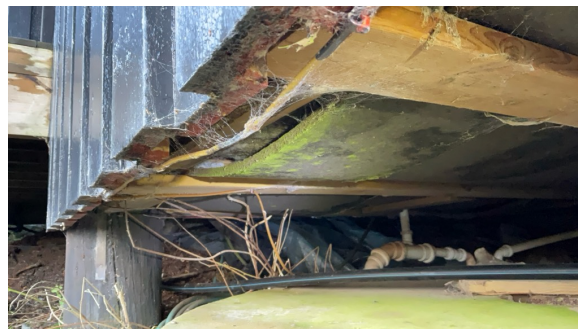
Vindsperre med åpning
