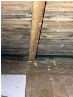
Spor etter borrebiller, her under flis under taksperre.
