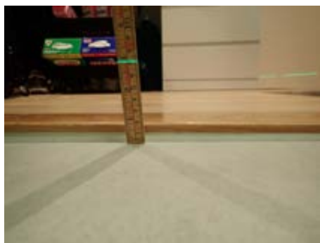
30 mm høyere ved dørterskel fra sluk
