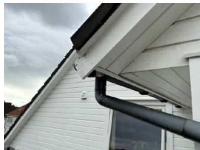
Fukt/råteskade på vindski.
