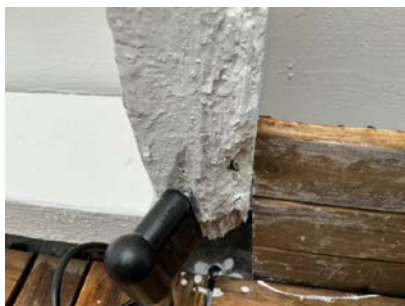
Fukt/råteskade på rekkverk.
