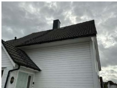
Synlig skjevhet/sig i takkonstruksjon observert fra bakke.
