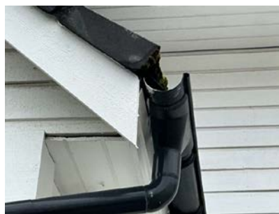
Ende-stykke mangler på takrenne ved inngang.
