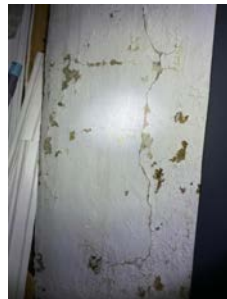
Sprekk på puss på pipe synlig på loft.
