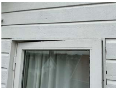
Vannbord er ikke montert over dør.
