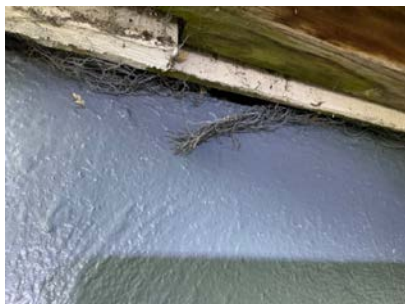
Hønsenetting er løsnet.
