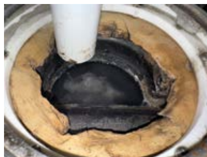
Sluk under dusjkabinett
