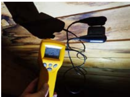
Ca 8 % fukt i trobordene - betegnes som tørt
