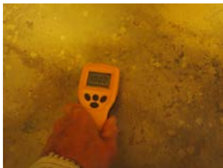
Det indikeres mye fukt i gulvene
