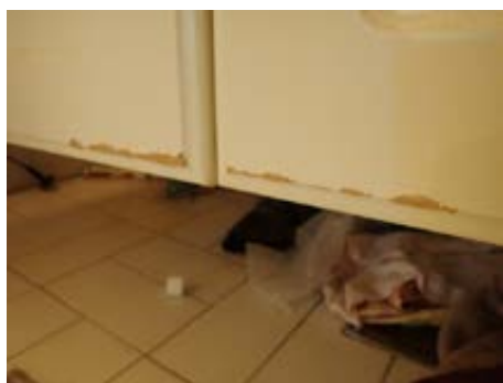
Fukt/vannskader i innrednings dørene
