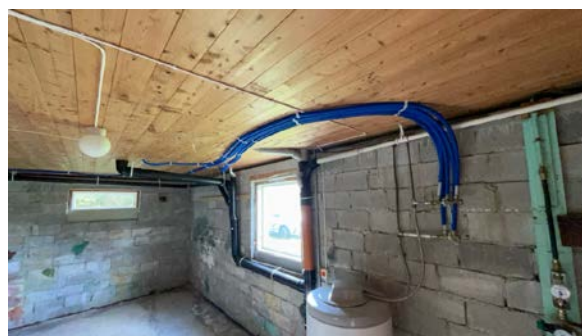
Bilde av vannledninger.
