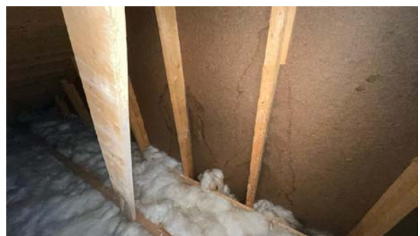
Fuktskjolder på vindtettplate på gavlvegg.
