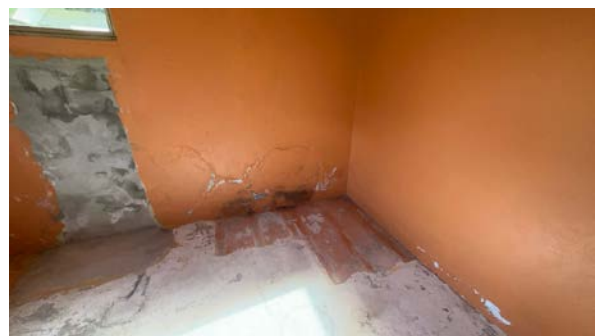
Saltutslag i mur/ betong
