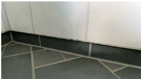
Sprekk i fuge.
