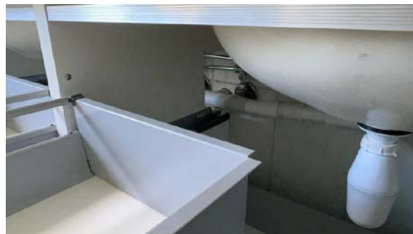
Rørgjennomføring i vegg er ikke tilstrekkelig tettet.
