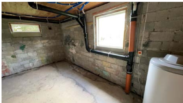
Bilde av avløpsledninger.
