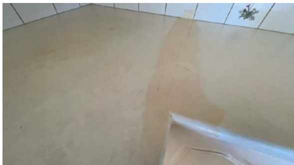
En malt skjøt på benkeplaten.
