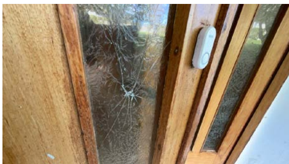
Sprekk i glass på hovedytterdør.
