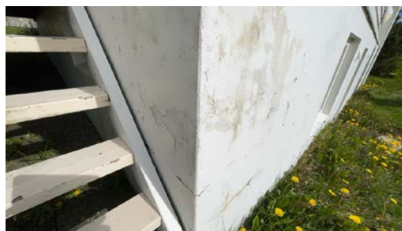
Avskalling og riss i grunnmur.
