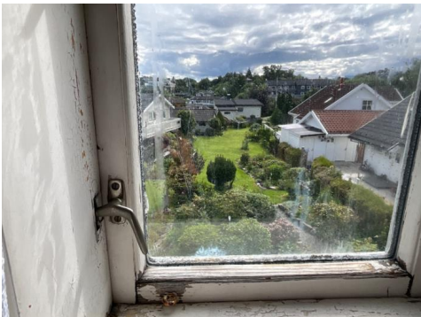
Tegn til kondes på vinduet innvendig og det er tydelige skader i karmen.
