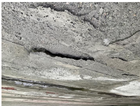
Avskalling i betongen fra undersiden av verandaen.
