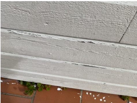
Noe værslitt kledning og det vokser busker ut fra undersiden av kledning.
