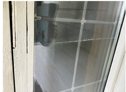
Sprekk i glassfelt ved siden av døren.
