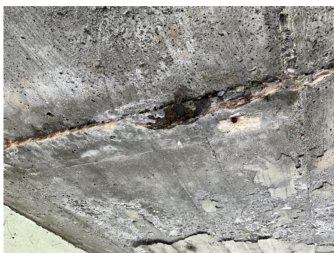
Fukt observert fra undersiden av verandaen.
