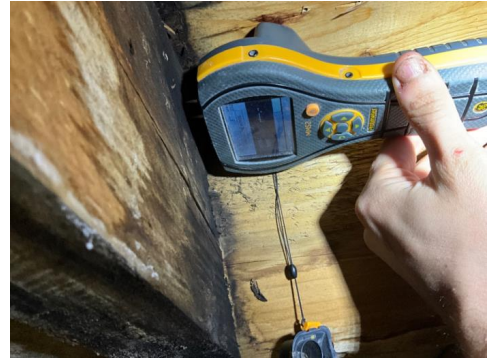
Fuktskjolde ved pipen.
