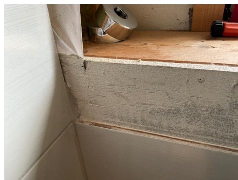
Tettesjiktet er ikke fullført. Dette er til høyre for dusj, ut mot vinduet.
