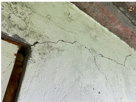
Sprekk i grunnmur.
