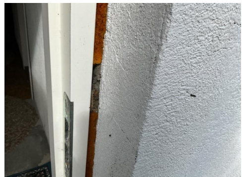
Ytterdør inn til underetasjen mot øst er ikke ferdigstilt.
