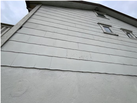
Eternittplater på vegg og det er begrenset lufting i underkant av disse.
