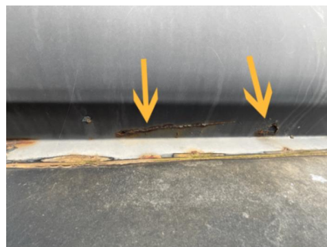
Det er sprekker i pipebeslaget.
