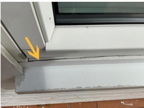
På ett av de nyere vinduene (fra 2009) er det en sprekk i karmen.
