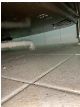
Avløp fra dusjkabinett rett i røroppstikk fra gulv.
