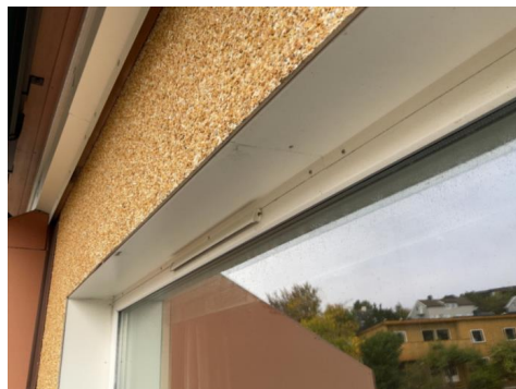
Manglende lufting/vannbrett over dører/vindu.
