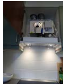
Ventilator med avtrekk fra bad.
